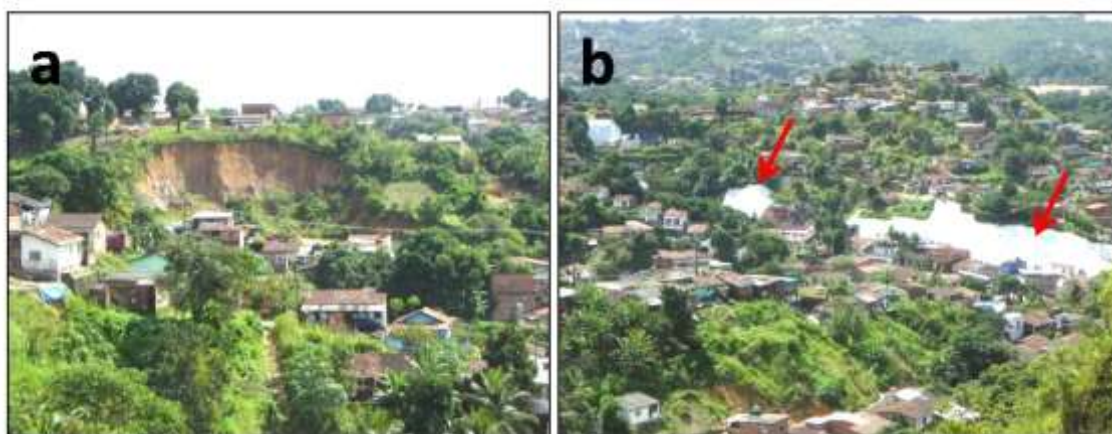
Figura 1. Cicatriz de escorregamento em área precariamente ocupada, com diversos cortes e aterros sob colina dissecada no município de Camaragibe (a) e vista panorâmica da densa ocupação de áreas de risco sob as formas tabulares e instalação de medidas mitigadoras paliativas (lonas plásticas – setas) (b).
